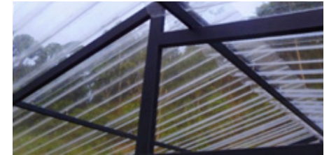
Ilustración 50. Ventilación superior en invernaderos.
