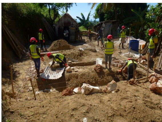
Sitio de construcción de la escuela de formación práctica con el socio Asociación para la Dignidad y el Respeto de la Mujer (ADRESFEM). Octubre de 2019, Valle de Jacmel (Departamento Sudeste).
